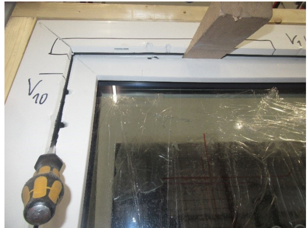
Bild 14 Schäden aus manueller Prüfung "Scheren-lager"
