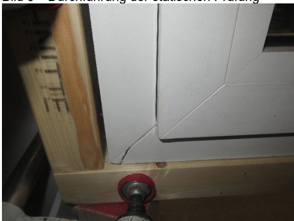
Bild 11 Schäden am Blendrahmen durch dynamische Prüfung
