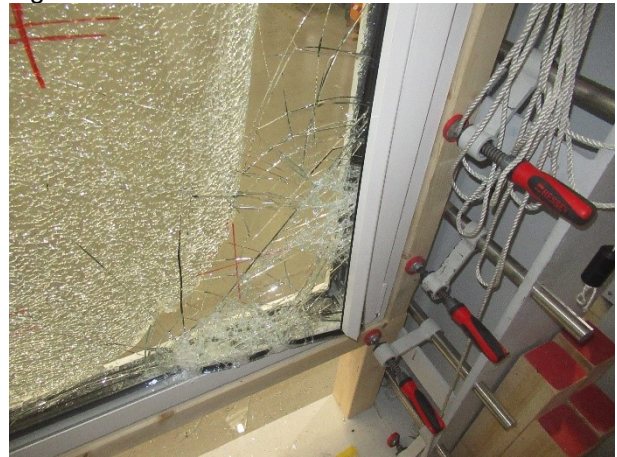
Bild 16 Schäden aus manueller Prüfung "Glas-anbindung" (Innenansicht)
