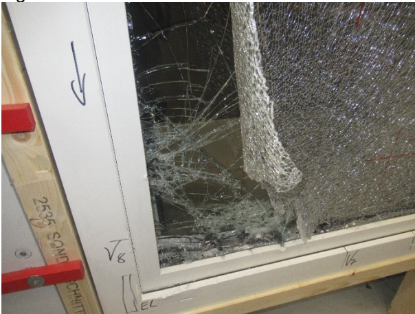
Bild 15 Schäden aus manueller Prüfung "Glas-anbindung"
